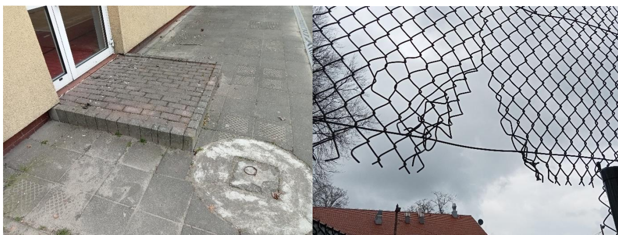
Rycina 15 Stan placu przyszkolnego i ogrodzenia boiska w Opatowie
